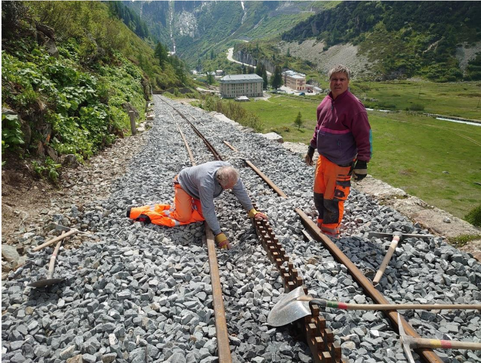
Werner Spahni und Marcel Schild graben im frisch eingebrachten Schotter eines der vielen Windenlöcher für die anstehenden Stopfarbeiten. Foto: Ruedi Schwarz.
