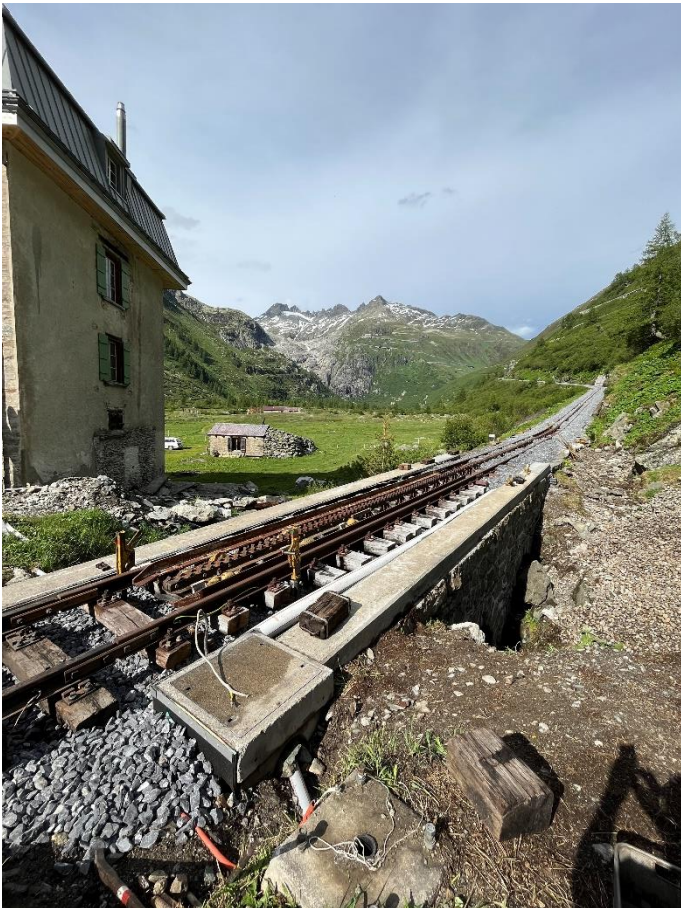
Die Zahnstangeneinfahrt ist berg- und talseitig verlascht. Als Nächstes muss zusätzlicher Schotter eingebracht werden. Später wird der gesamte Streckenabschnitt des Totalumbaus gestopft. Foto: Patrick Smit.
