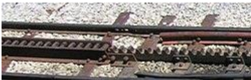
Übergang von einer Riggenbach-(links) zu einer Von Roll-Zahnstange
