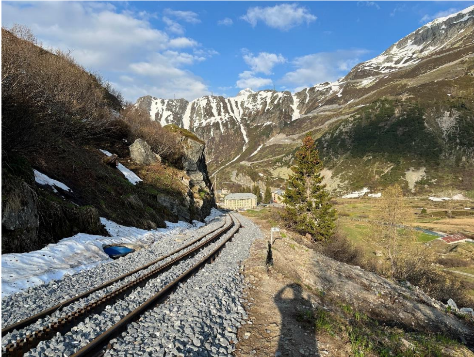
Situation bei Km 46.7. Der am Ende des Totalumbaus eingebrachte Schotter muss noch gestopft werden. Gleichzeitig muss das Gleis in die exakte Lage gebracht werden. Hierfür werden unter anderem die Versicherungspunkte benötigt. Foto: Patrick Smit.
