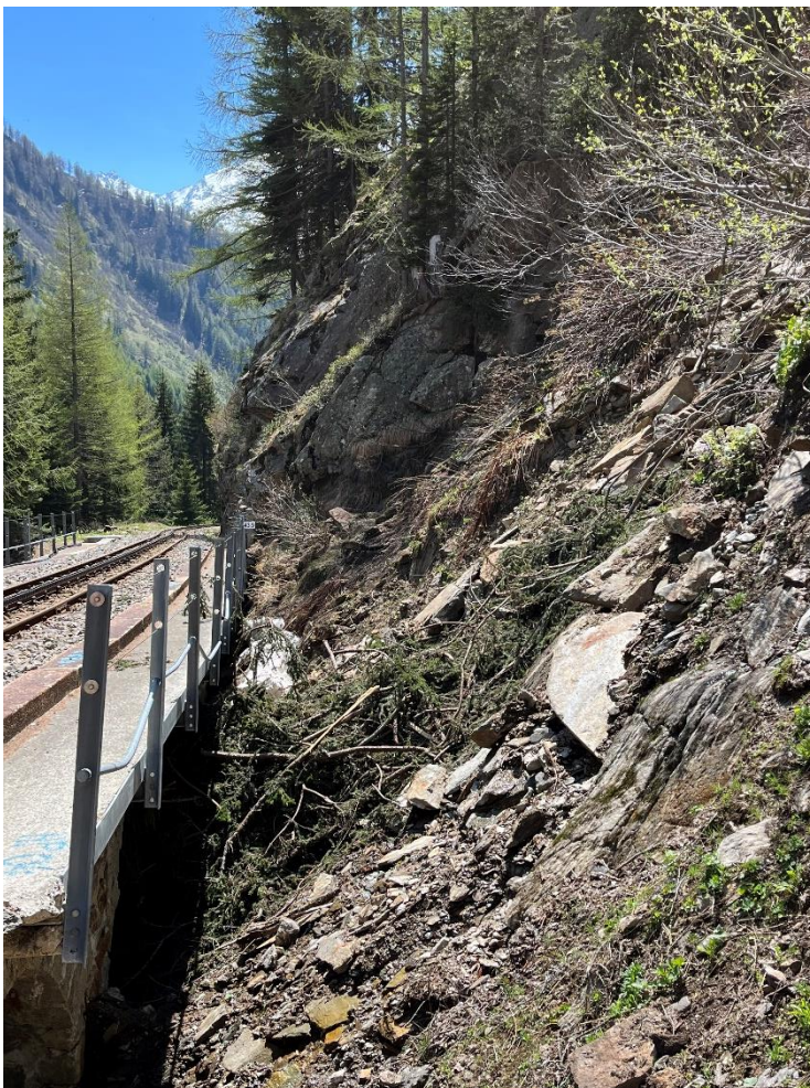
Felsrutsch oberhalb des Lehnenviadukts Eischflü. Unterhalb und oberhalb der Strassenbrücke vor dem Strassentunnel befindet sich noch viel loses Material. Foto: Patrick Smit.
