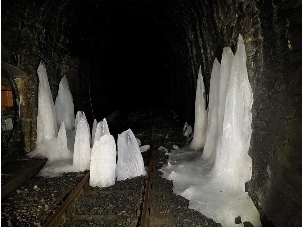
Eis-Stalagmiten im westlichen Eingangsbereich des Scheiteltunnels.
