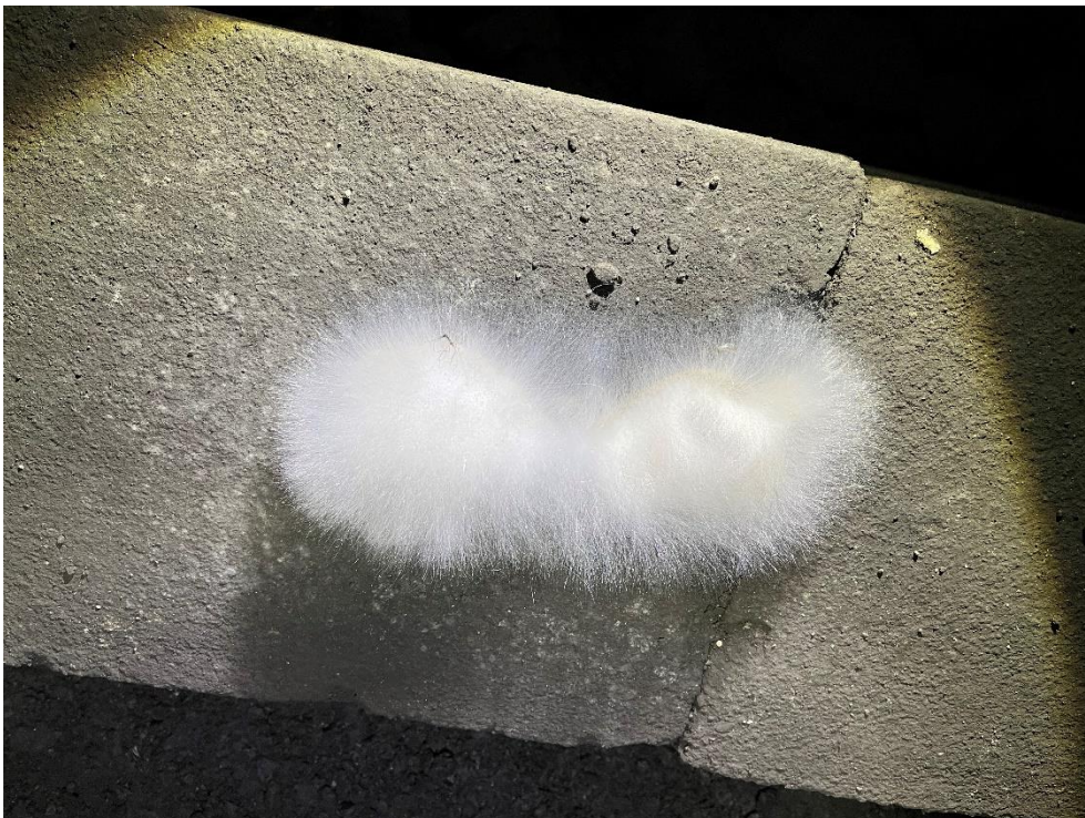
Im Stockdunklen Scheiteltunnel entdecken wir an mehreren Orten Schimmelpilze an unbehandeltem organischem Material (z.B. Splitter von Bauholz).
