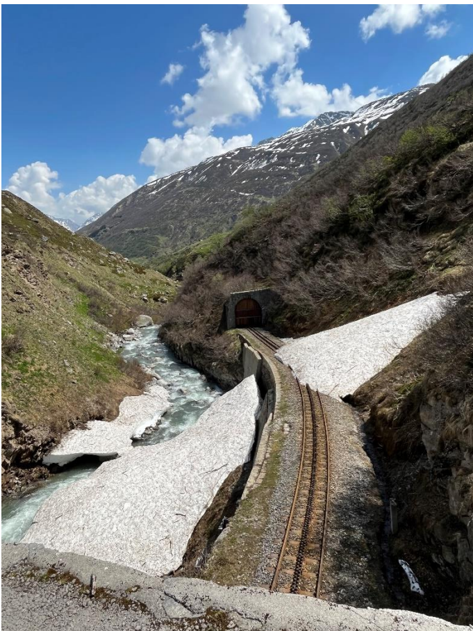
Der «übliche» Lawinenkegel zwischen Tunnel 2 und 3. 2018 hat diese Lawine das bergseitige Tor des Tunnels 3 eingedrückt und den Tunnel zu ca. \frac{1}{4} mit Schnee verfüllt. Auch hier lag das bergseitige Portal des Tunnels damals unter 2 m Schnee. Foto: Patrick Smit.
