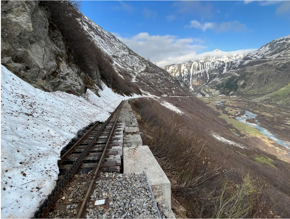
Situation bei der Hilfsbrücke bei Km 47.8. Foto: Patrick Smit.
