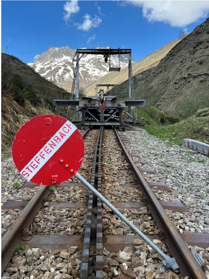
Dank den günstigen Verhältnissen wurde die Montage der Steffenbachbrücke zeitlich vorverschoben. Foto: Patrick Smit.
